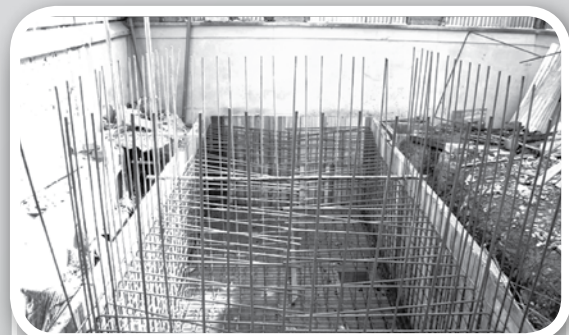
Tanque de almacenamiento para el sistema de abasto y la red contra incendios
