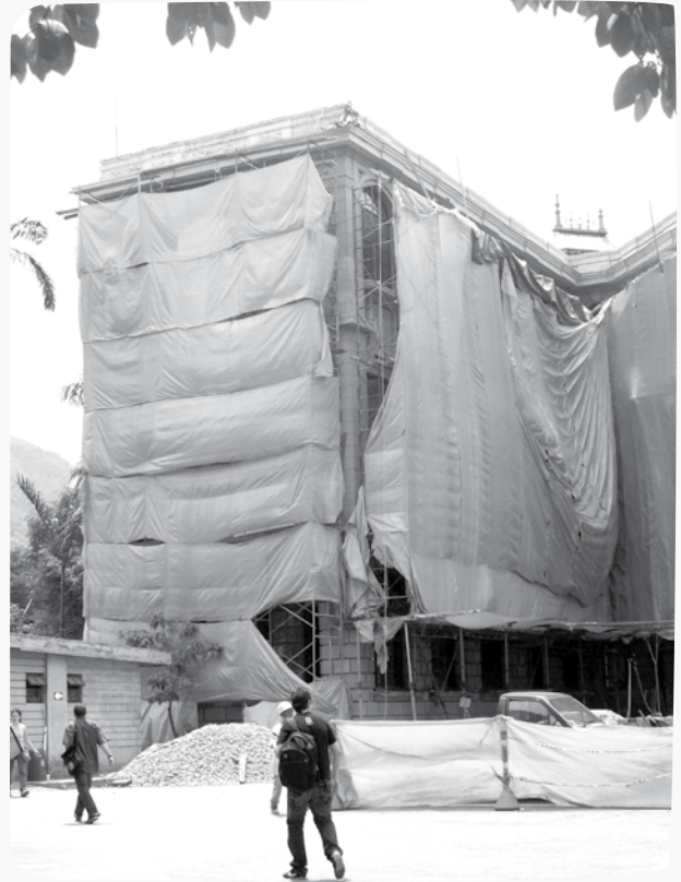
Edificio de Bioquímica en obra (Actualmente, Edificio Histórico Manuel Uribe Angel, nombre aprobado por el Consejo de Facultad)
