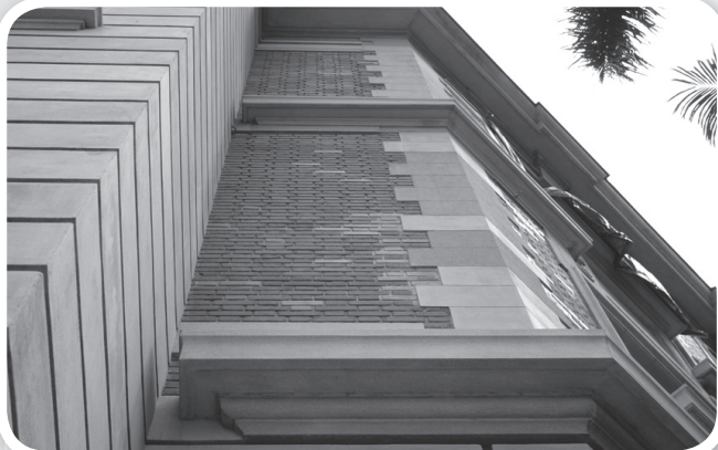
Detalle de un segmento de fachada con reintegros de piezas de ladrillo y revoques nuevos una vez lavada e hidrofugada la superficie.
